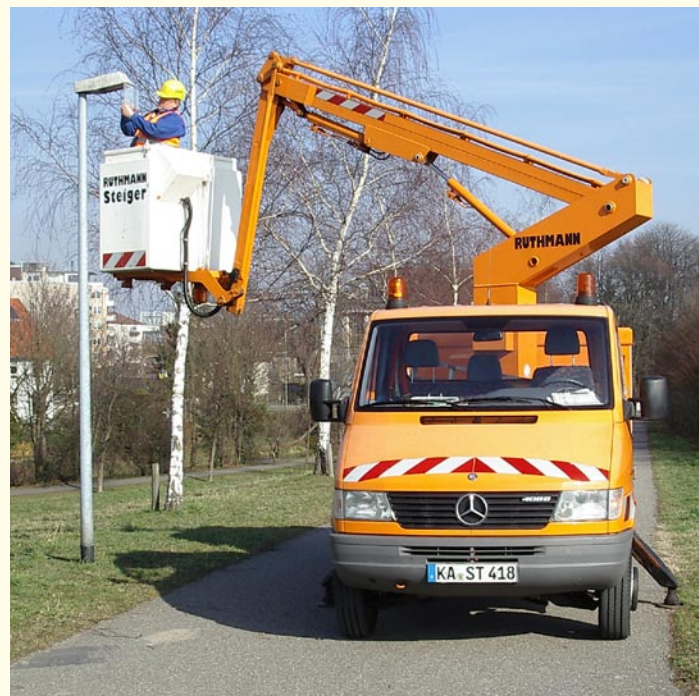
Lebensdauer der Lampen sowie Ersatz- und Wartungskosten müssen bei der Planung berücksichtigt werden.
