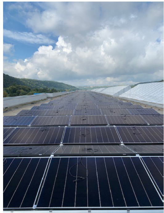
Photovoltaik-Anlage am Standort Dörzbach
