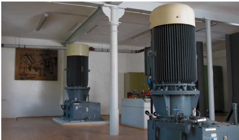
Wasserkraftwerk am Fluss Kocher (Innenansicht)
