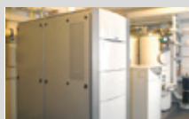
BZ-Tests mit Kleinkraftanlagen
